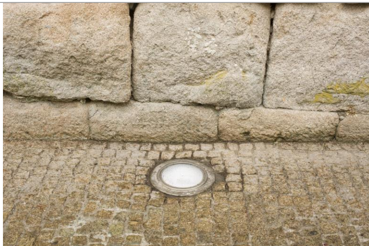
Elemento LUMINARIA / PAVIMENTO Cor Elemento:
